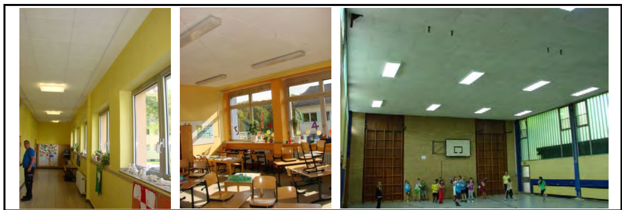
Abbildung 4.4-9: Wendelinusschule: Beleuchtungsanlagen Schule und Sporthalle
