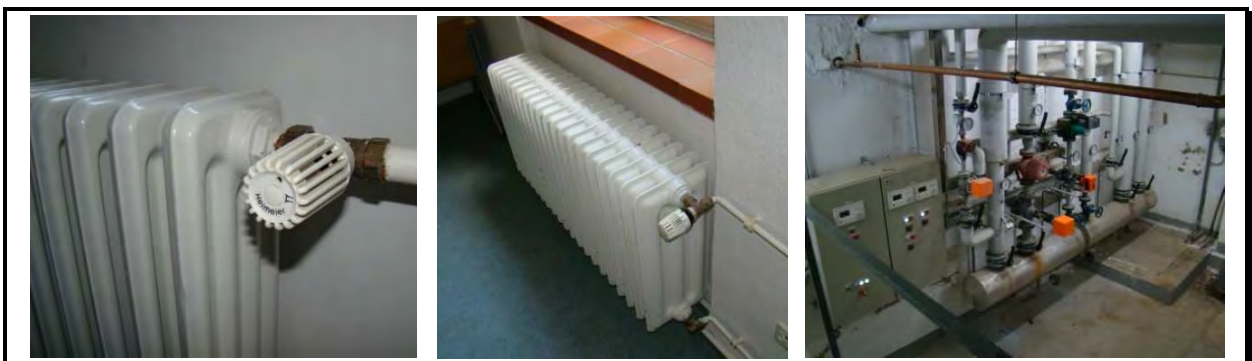
Abbildung 4.13-7: VHS (Alte Schule): Heizkörper und Heizverteiler
