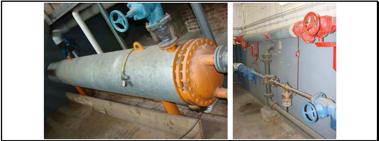
Abbildung 4.9-12: Friedrich-Ebert-Realschule: Alter Fernwärmetauscher und ungedämmte Leitungen im Heizkeller zu Bauteil E
