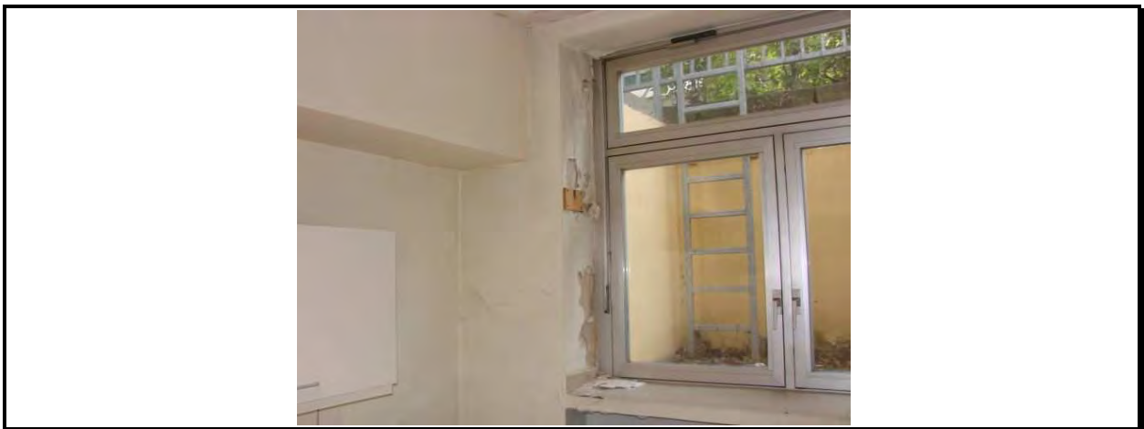
Abbildung 4.9-13: Friedrich-Ebert-Realschule: Bauteil B: Feuchtes Mauerwerk im Untergeschoss
