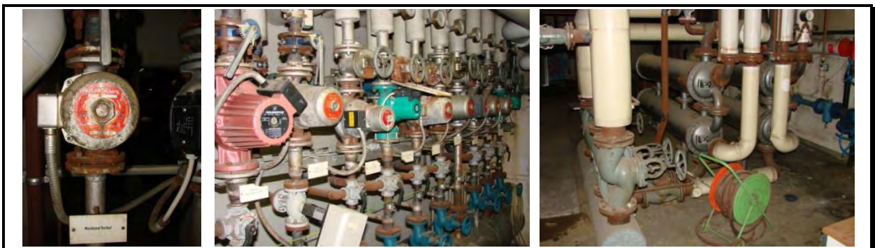
Abbildung 4.10-11: Ernst-Mach-Gymnasium: Sanierungsbedürftige Heizzentrale aus den 60er Jahren
