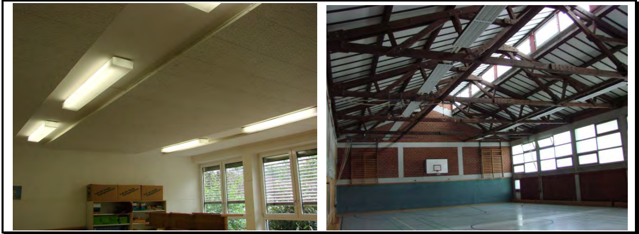
Abbildung 4.3-8: GS Am Clementinenhof: Beleuchtungsanlage Schule und unregelte Lichanlage Turnhalle
