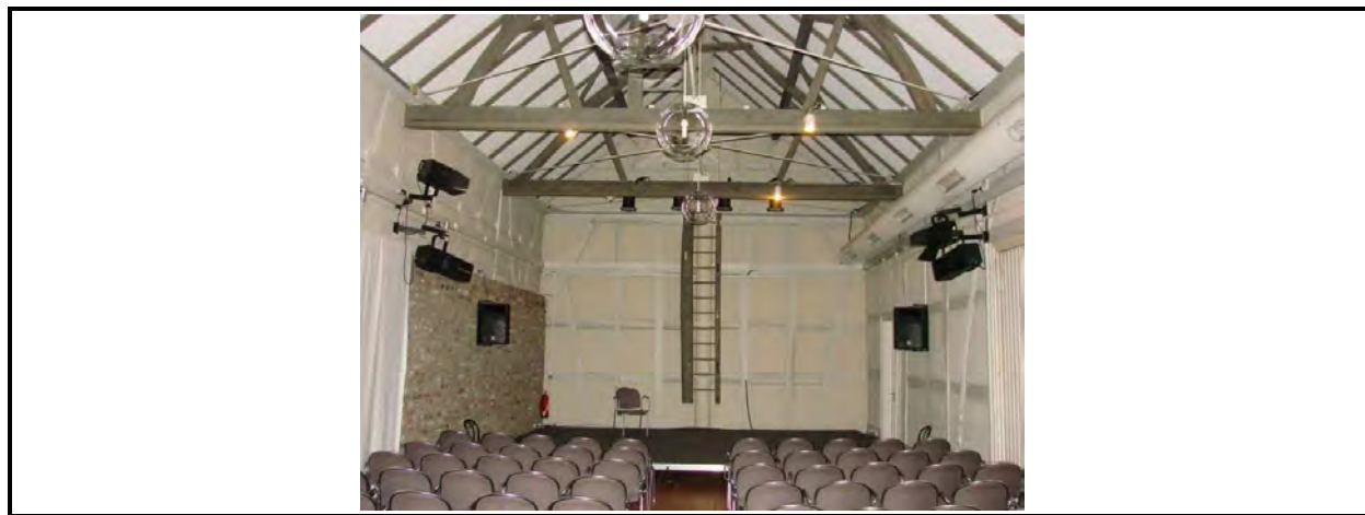
Abbildung 4.12-5: Löhrrhof: Beheizungsprobleme in der Tenne
