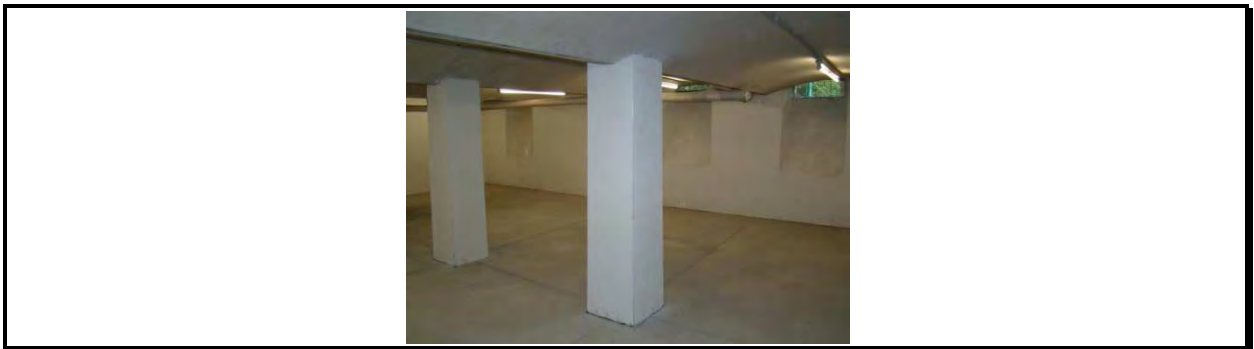
Abbildung 4.13-9: VHS (Alte Schule): Sanierter Keller ohne Kellerdeckendämmung
