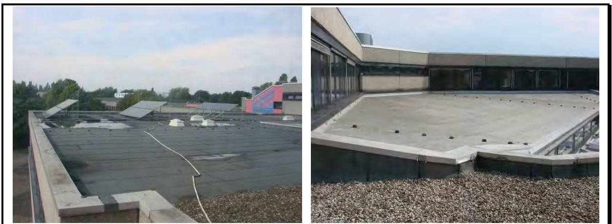
Abbildung 4.11-7: Schulzentrum Sudetenstraße: Dach mit PV-Anlage und Dach PZ
