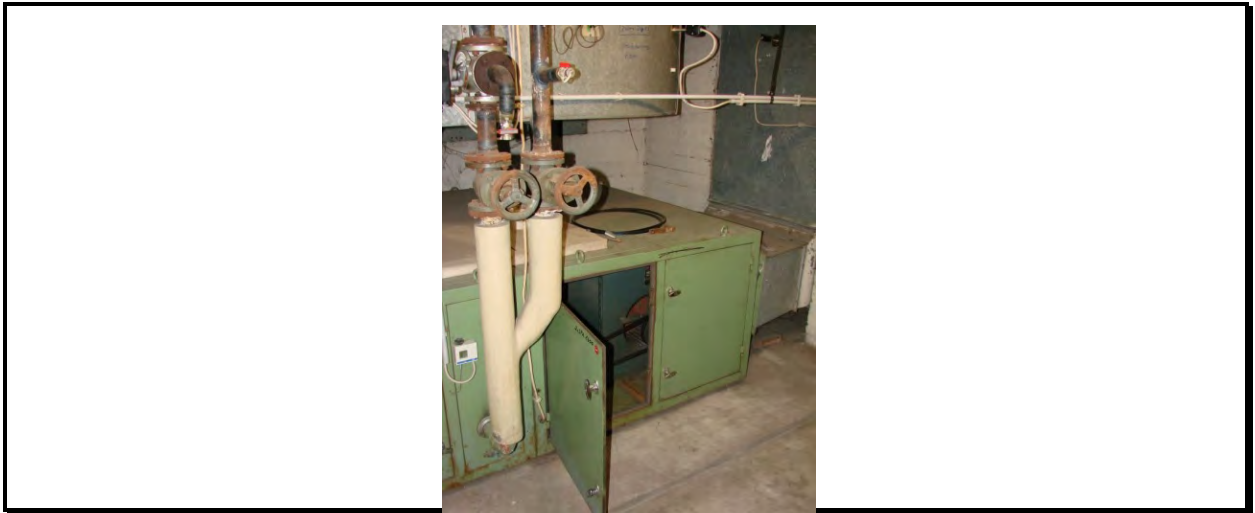
Abbildung 4.5-9: Brüder-Grimm Schule: Sehr alte Lüftungsanlage (ohne Typenschild) der Turnhalle
