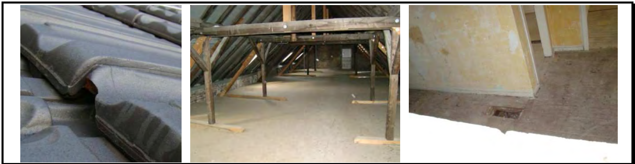
Abbildung 4.13-6: VHS (Alte Schule): Ungedämmte Dächer müssen bald nach EnEV gedämmt werden
