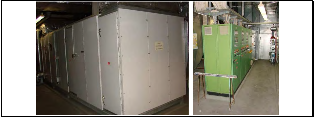
Abbildung 4.14-7: Rathaus: Technikzentrale Lüftung Römersaal (li) und Lüftungssteuerung (re)
