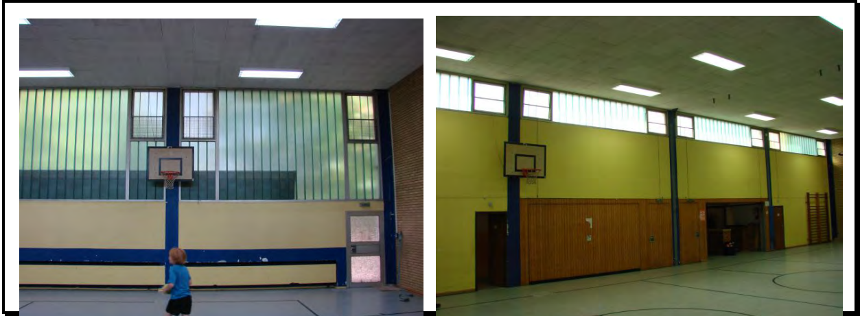
Abbildung 4.4-10: Wendelinusschule: Energetischer Schwachpunkt [hier fehlte ein Leerzeichen] Glasfassade
