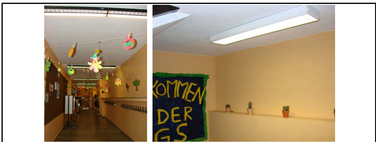
Abbildung 4.6-8: Deutscherrenschule: Veraltete Beleuchtung Bauteil A Flur (ii) und Treppenhaus (re)
