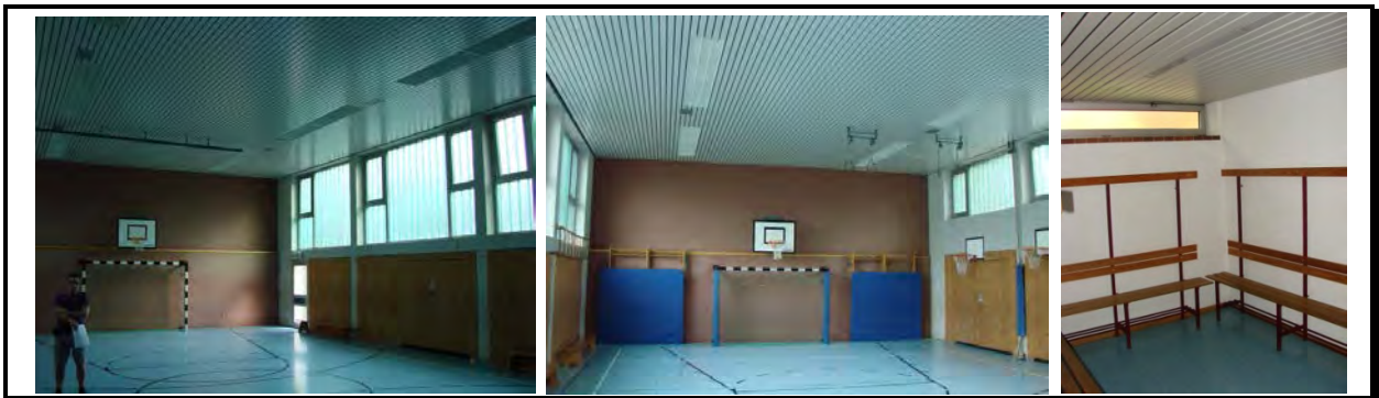
Abbildung 4.2-8: Bodelschwingschule: Energetische Schwachpunkte Glasbausteinwände und Beleuchtung
