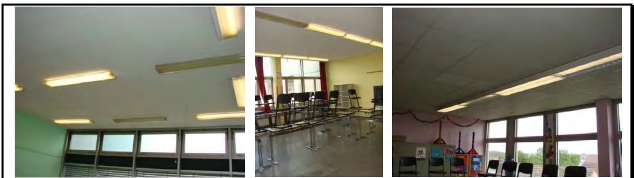
Abbildung 4.8-9: HS Kendenich: Alte Beleuchtungsanlagen in den Klassen
