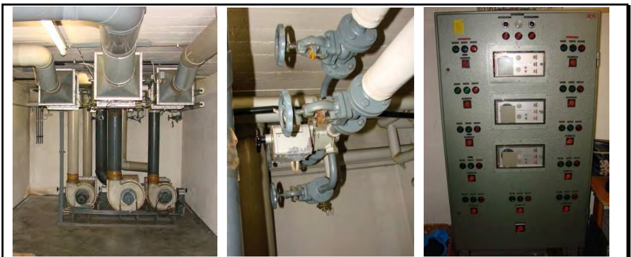
Abbildung 4.10-14: Ernst-Mach-Gymnasium: Lüftungsanlage in der Sporthalle (ohne Eingriffs-/Steuermöglichkeit)
