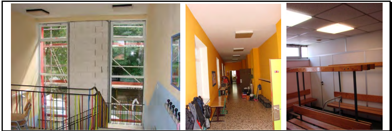
Abbildung 4.1-7: Carl-Orff-Schule: Sanierungsbedürftige Lichtanlagen in Schule und Turnhalle
