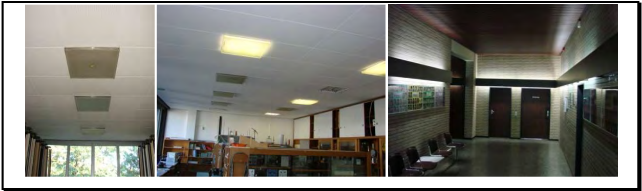
Abbildung 4.10-12: Ernst-Mach-Gymnasium: Sanierungsbedürftige Beleuchtung in den Klassen
