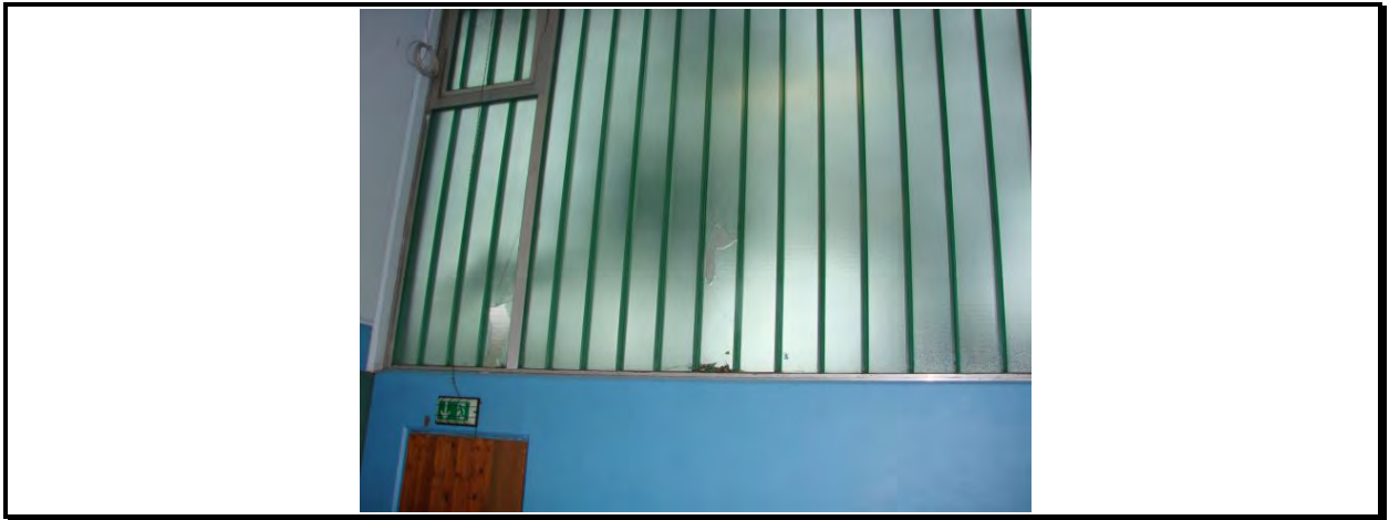
Abbildung 4.6-10: Deutscherrenschule: Schlecht gedämmte und teilweise defekte Glasfassade der Turnhalle
