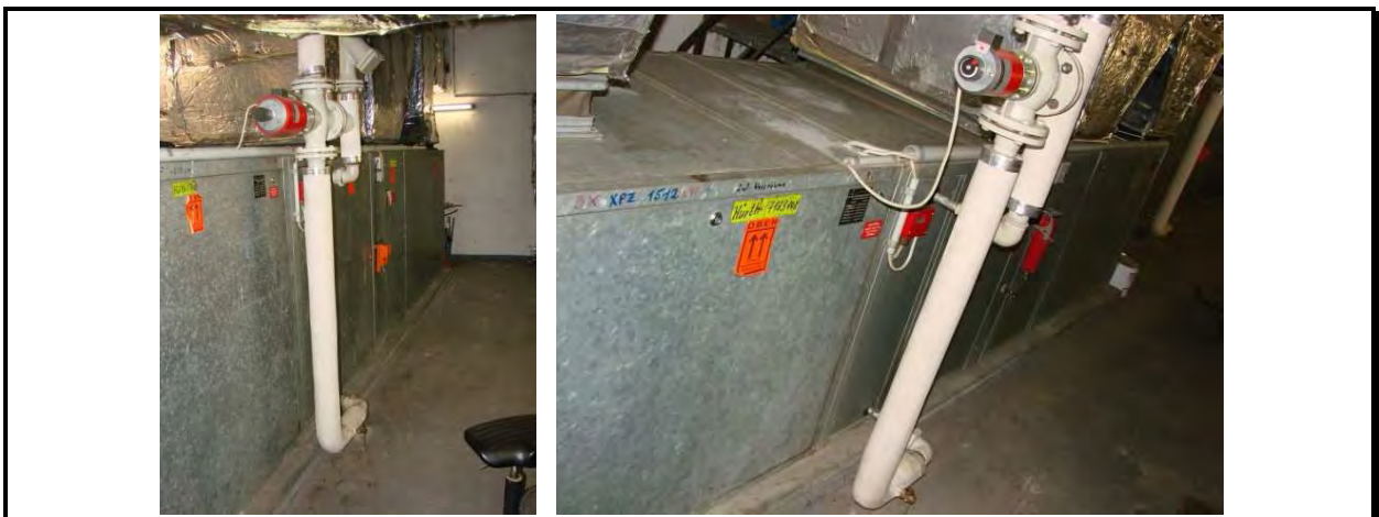
Abbildung 4.11-11: Schulzentrum Sudetenstraße: Lüftung Sporthalle (li) und Lüftung Nassräume (re)
