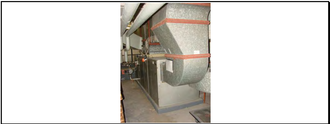
Abbildung 4.8-8: HS Kendenich: Lüftungsanlage Aula Baujahr 1966
