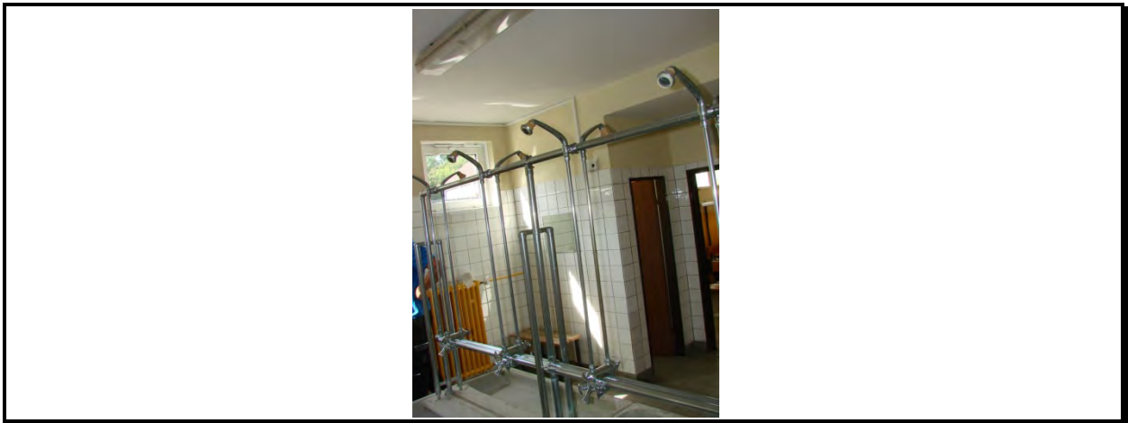
Abbildung 4.4-11: Wendelinusschule: Duscharmaturen Turnhalle
