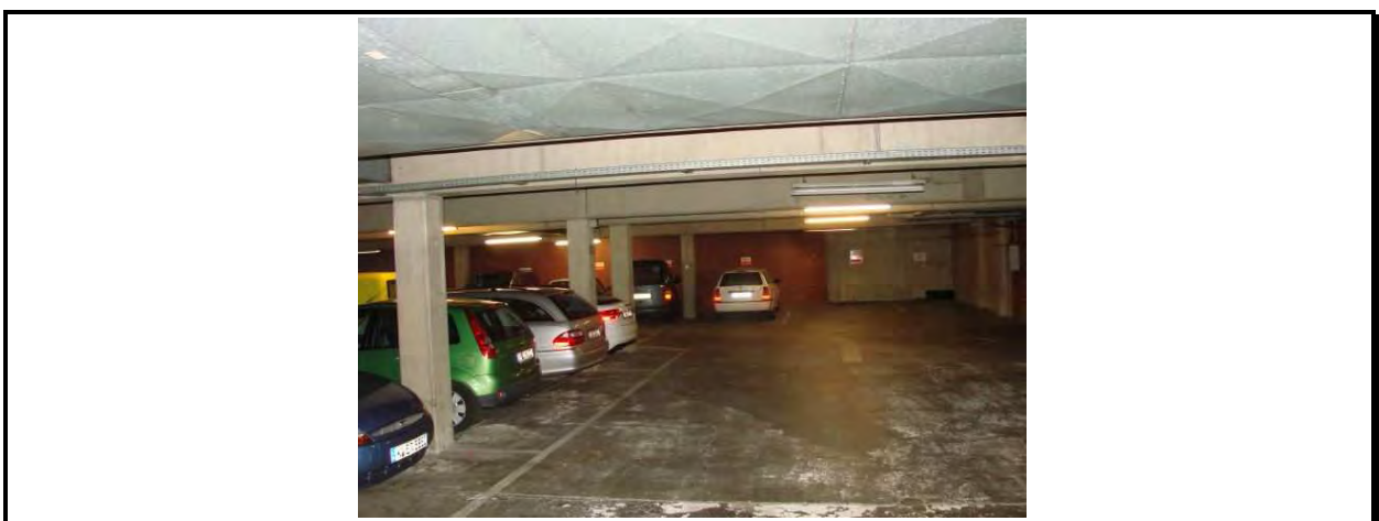
Abbildung 4.14-9: Rathaus: Beleuchtung Tiefgarage
